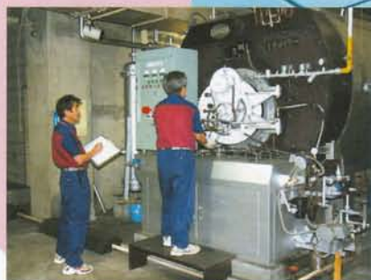
冬季ボイラー運転操作（地下室）
